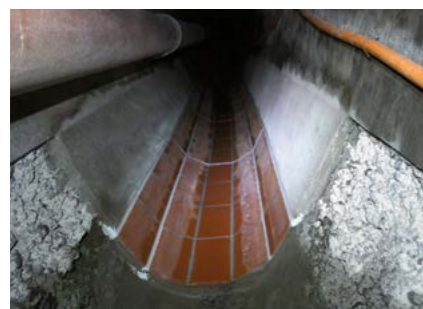
Réseaux enterrés (assainissement)
